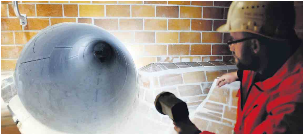
In die Röhre gucken. Kanäle wie dieser leiten das Abwasser zu Pumpwerken und weiter ins Klärwerk. Bei starkem Regen ergießt sich der Dreck oft in die Spree. Um das zu verhindern, werden Becken und Wehre in der Kanalisation installiert, um die Brühe in den Röhren zwischenspeichern. Letztere Variante ist die billigere von beiden.
